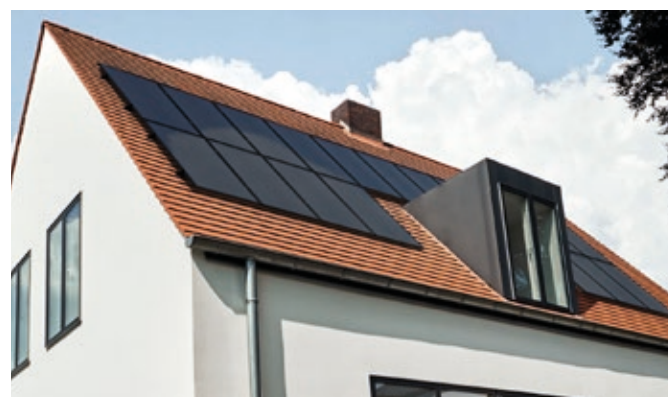
PV-Module für selbsterzeugten Strom
